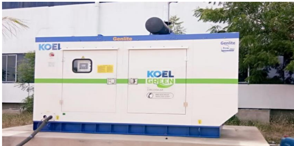
35 KVA Genset - AAACET
